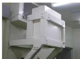
サイクロトロン室遮蔽体
